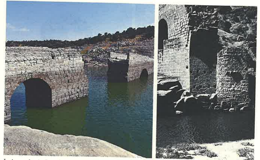
Imágenes 8 y 9. Cortadura practicada en el puente durante la Guerra de la Independencia. (Img.8. Foto anterior a la inundación, gentileza de D. Antonio González Cordero. Img. 9. Foto actual, J. Timón).
